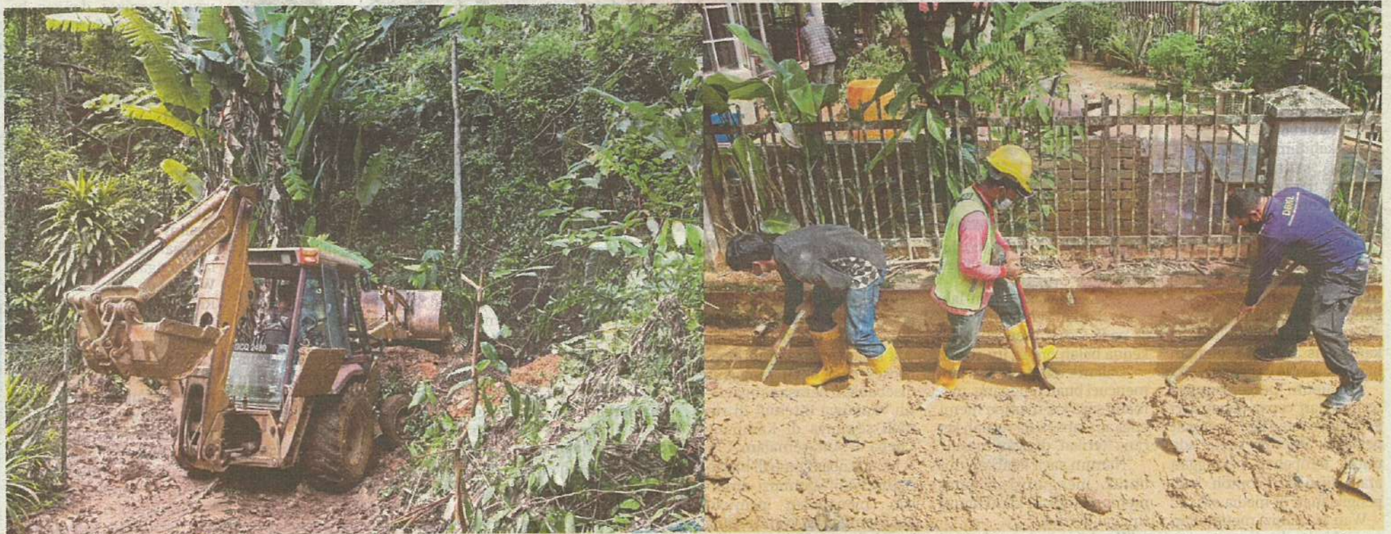
PETUGAS DBKL berada di lokasi tanah runtuh bagi membersihkan, memantau keadaan sekitar susulan kejadian tanah runtuh yang berlaku di tanah persendirian dekat Jalan 1/27D di Seksyen 6, Wangsa Maju.
