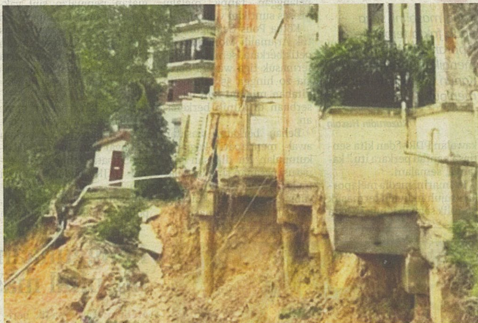
KEADAAN Kondominium Sri Duta 1 yang terjejas akibat tanah runtuh.
